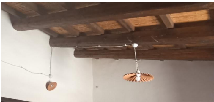
Figura 17 Dettaglio corpi illuminanti
