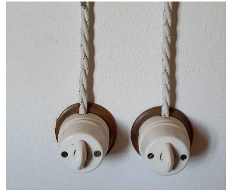
Figura 1 - Particolare interruttori elettrici
